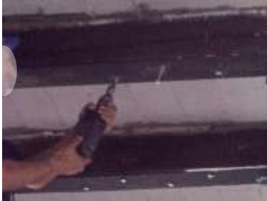
6. Con la pletina 1 prefijada, realizar en la viga de madera el resto de taladros que lleva la pletina
