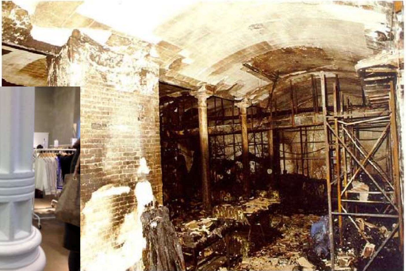
Font: Incendi amb pilars de fosa. Bombers Barcelona
