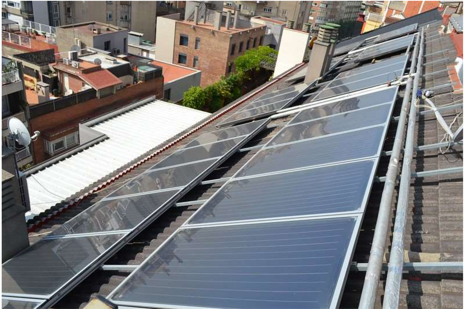
Instal·lació de plaques solars en una comunitat per obtenir aigua calenta.
